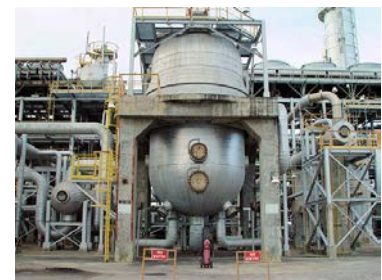
Trinidad methanol reactor.
