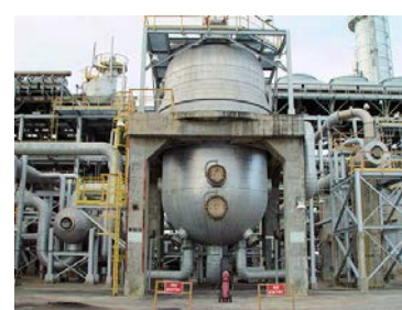
Trinidad methanol reactor.
