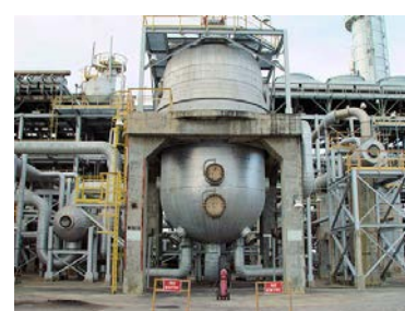
Trinidad methanol reactor.
