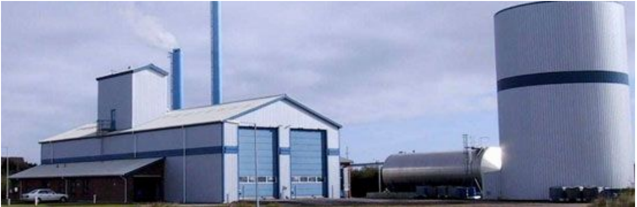
Harboøre Varmeværk. Modstrømsforgasser taget i brug 1996 med langt over 100.000 driftstimer bag sig.
